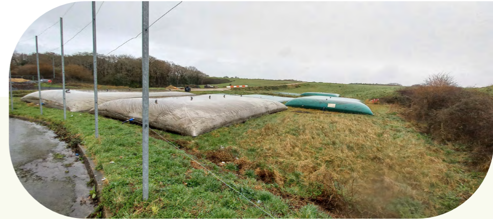
Extraction des lixiviats
